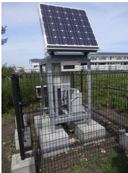
図5 日立製作所製 NaI/半導体型（設置地点：浪江町 請戸局*（福島県所有）
