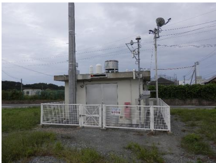
図 6 局舎上の固定型モニタリングポスト（設置地点：富岡町 富岡局*（福島県所有）
