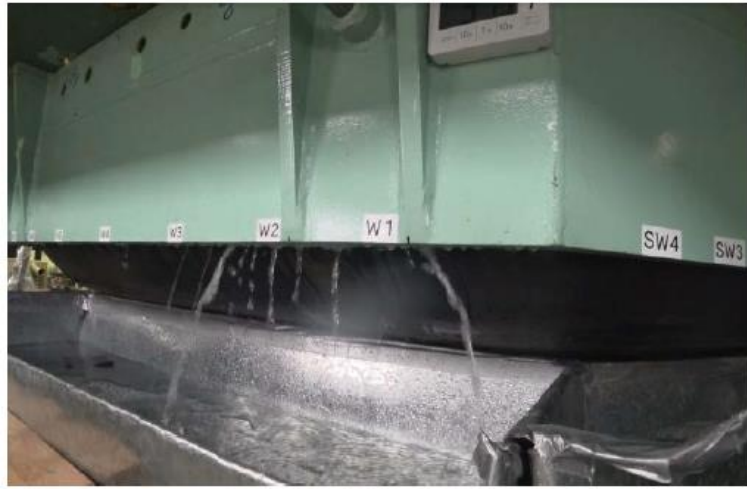
図 2-37 試験時の耐震ジョイントからの漏水状況 (Y=250mm)
