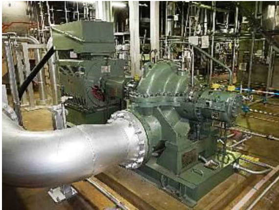
ポンプ，配管，支持構造物の例
