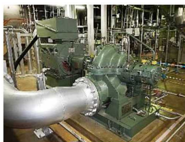
ポンプ、配管、支持構造物の例
