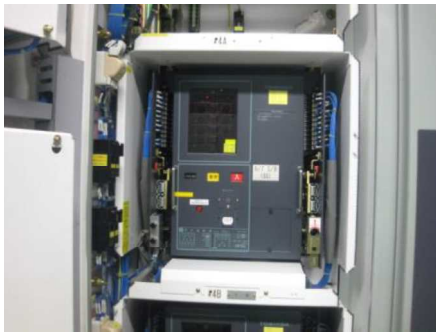
気中遮断器の例 (P/C)
