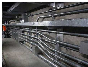
ケーブルトレイ、電線管の例
