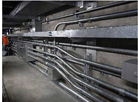
ケーブルトレイ，電線管の例
