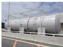
② 重油タンク
