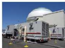
① 空冷式非常用発電装置
