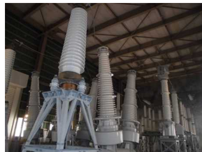
(b) 154kV 開閉所（屋内）
