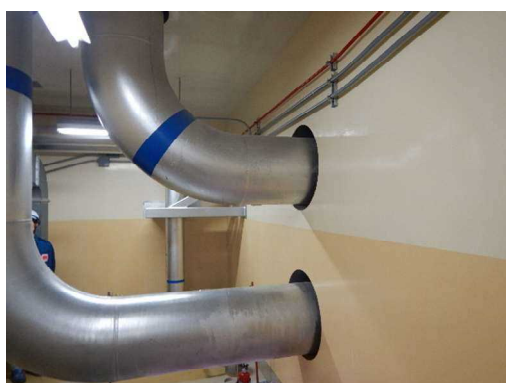
図3. 貫通孔の隙間の例
