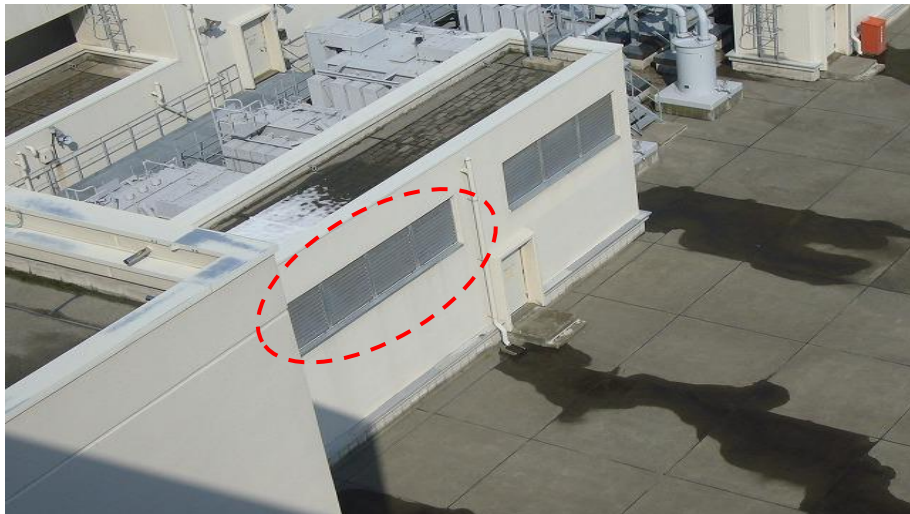
図 7-3 中央制御室換気空調系の外気取入口
