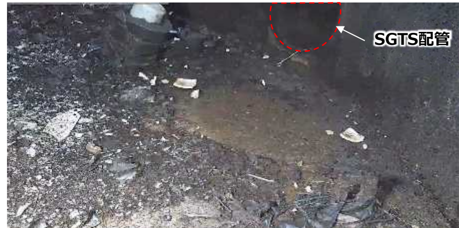
写真：SGTS配管状況（5/20雨天時）
