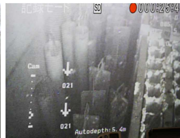
【SFP内の制御棒ラック、フィルタの様子】
