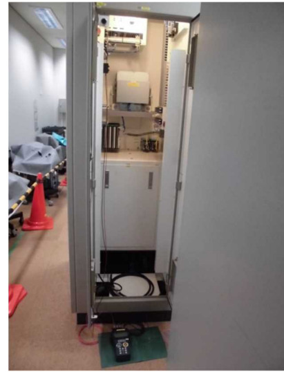
<可搬型計測器接続>
