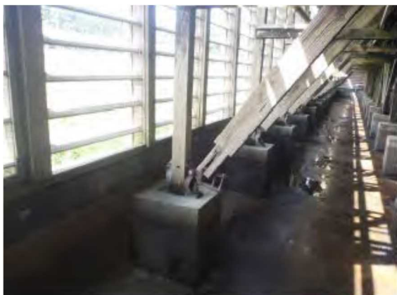
木製筋かい（倒壊前）
