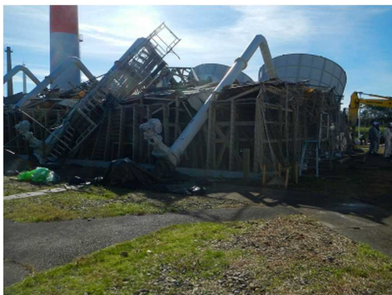
2次系冷却塔 倒壊状況
