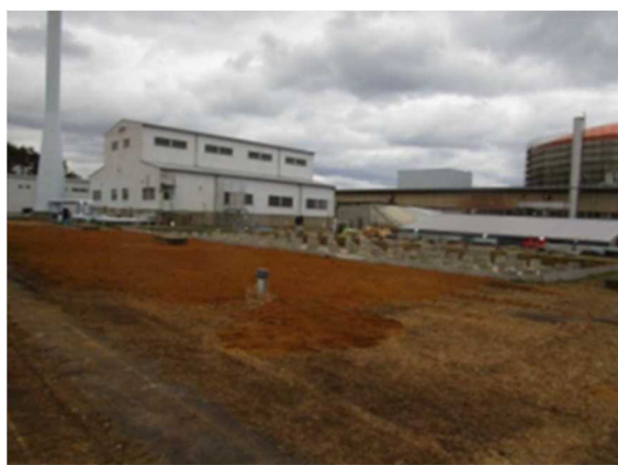
倒壊資機材撤去の状況（基礎台）
