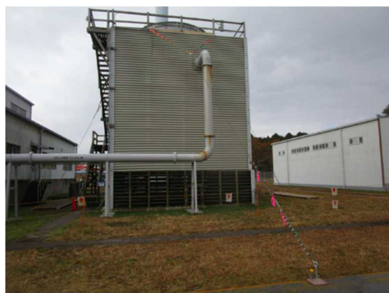
UCL系統冷却塔のワイヤーロープによる固定
