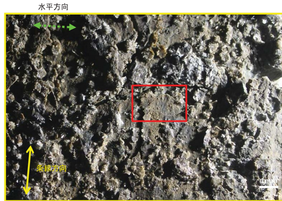
断層面の状況
