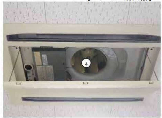
エアコン (α線測定室) No. 4
