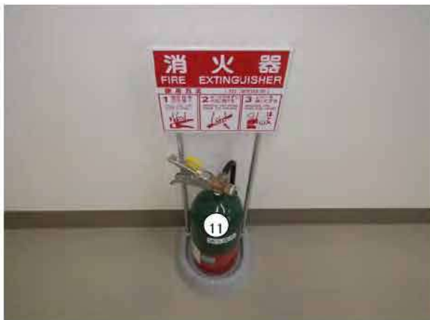
消火器 (α線測定室) No. 11
