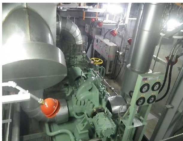
図27-2 4タービン動補助給水ポンプ 外観
