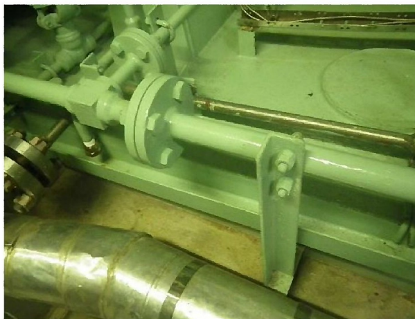
図27-3 4タービン動補助給水ポンプ 漏洩拡大防止措置
