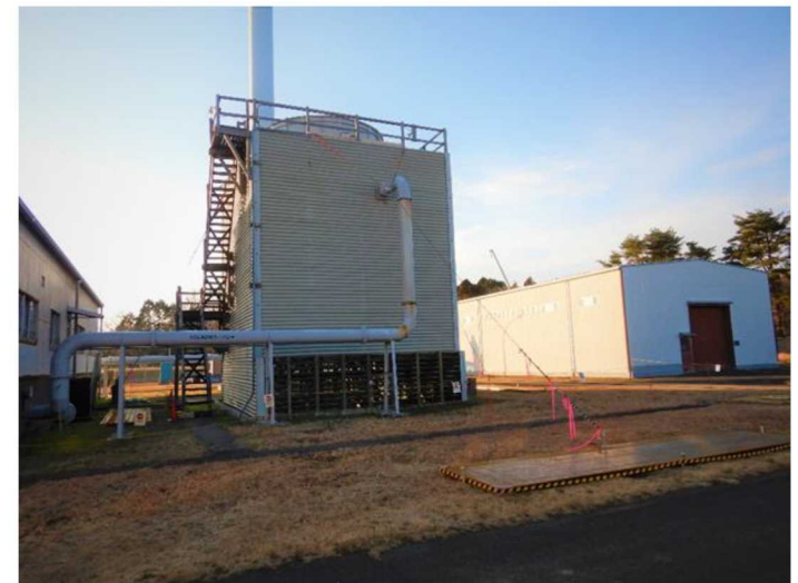
UCL系統冷却塔のワイヤーロープによる固定写真
