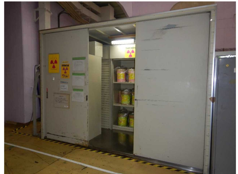
金属製の保管庫(保管廃棄施設)の一例
