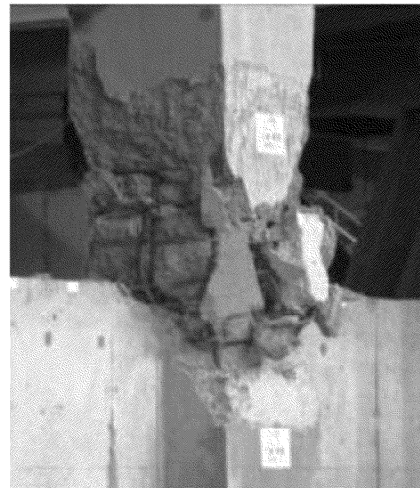
(1階柱の破壊状況)
