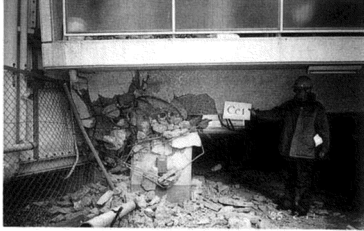
(1階柱の破壊状況)
