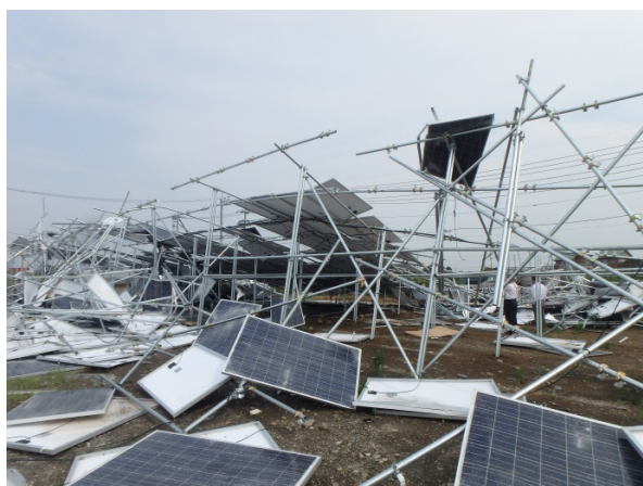
(b)太陽光発電システムの被害(写真提供:奥地建産(株))
