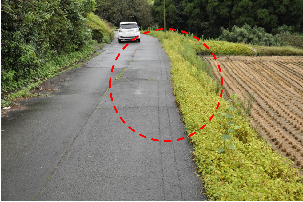
図 2-9 福原地区現地状況（道路右横ずれ）
