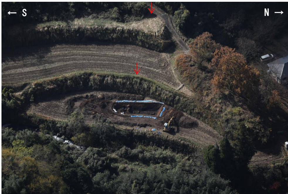
図 2-49 ピット全景 (2017/12/01 撮影、矢印は変状確認位置)
