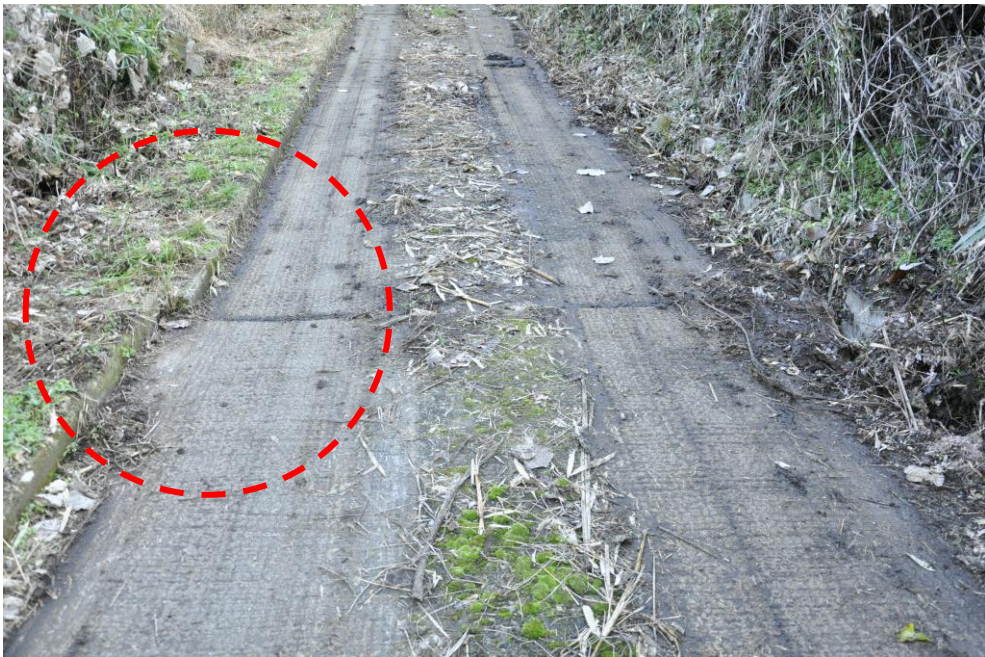
図 2-14 土林地区現地状況（コンクリート右横ずれ）
