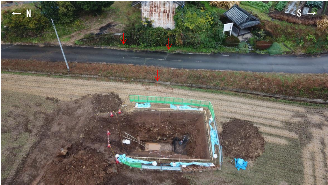
図 2-24 ピット全景（2017/12/01 撮影、矢印はクラック位置）
