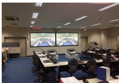
TV会議システム等通信設備
