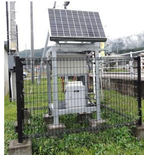
日立製作所製 2台
