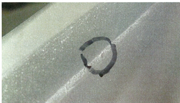
図 7.1.3-参 7 破裂状態の例 No. 11 (穴)
