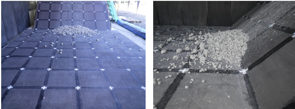
崩落状況 [試番8]
