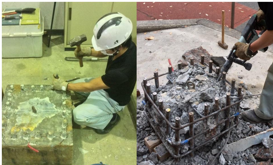
図 2.6.2-10 腐食鉄筋の取り出し
