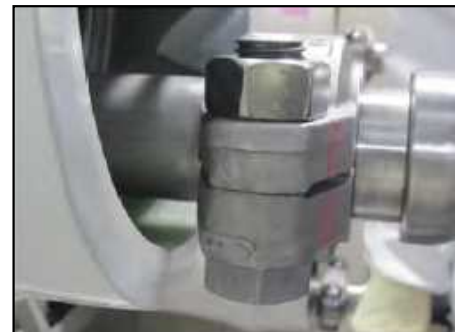
【仮復旧後】配管芯ずれ確認
