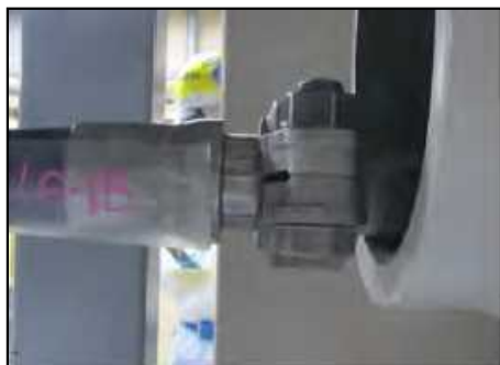
【分解前】配管芯ずれ確認
