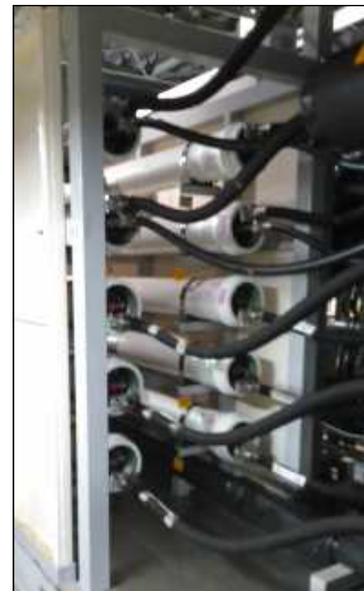
ROユニット(B)現場状況
