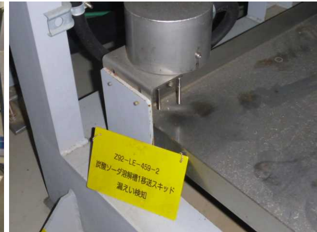
受けパン及び漏えい検出器設置の状 況 (炭酸ソーダ貯槽移送スキッド)
