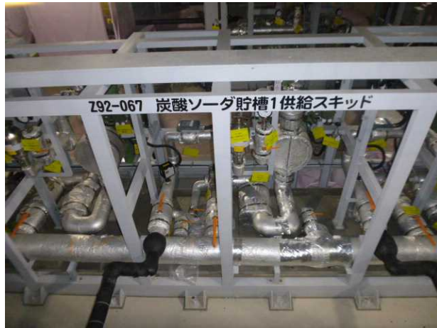
炭酸ソーダ貯槽1供給ポンプ (スキッド)
