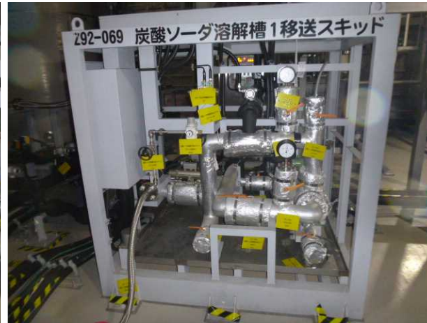
炭酸ソーダ溶解槽移送ポンプ (スキッド)
