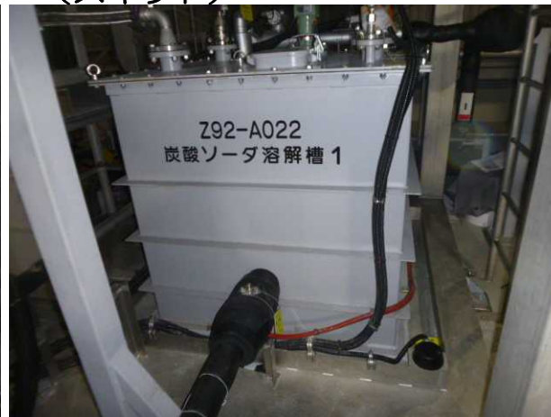
炭酸ソーダ溶解槽 (製造スキッド)
