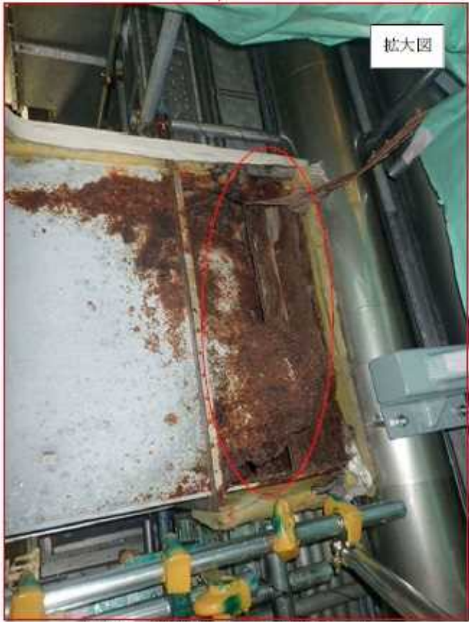
腐食孔（縦約100cm×横約30cm）
