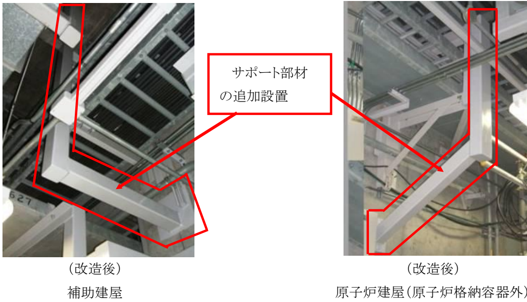
ケーブルトレイサポートの改造例
