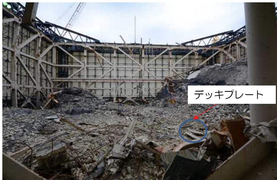
写真1:崩落屋根上のガレキ状況 (西側から撮影)
