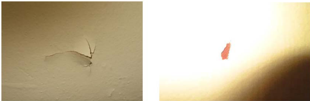
図4. 1 軽微な塗膜の劣化の例 (注)
