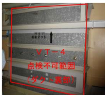
干渉物裏（ダクト裏）
