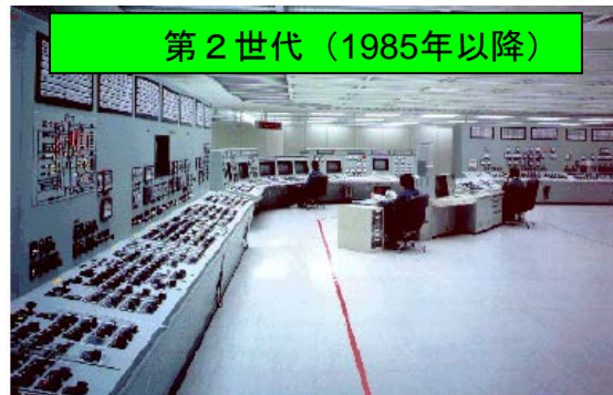
CRT上に系統図、パラメータのデジタル表示、トレンド表示などプラントの運転状態をより理解しやすいようなインターフェース機能を導入
