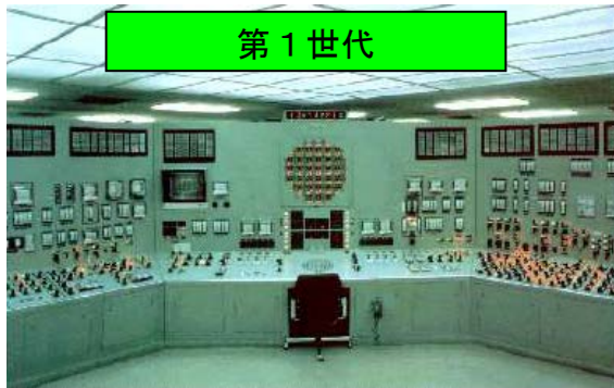
アナログ式の計器、制御装置を用いたシステム
