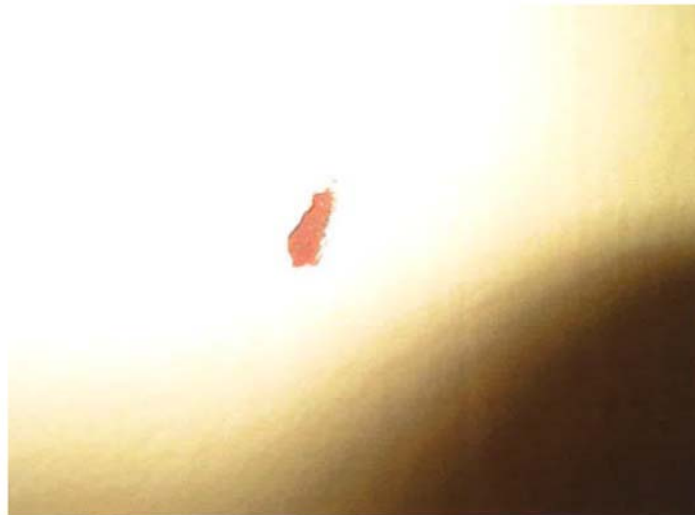
（例）下塗りが見えている塗膜状況（円筒部内面）
