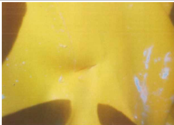
雨カバー表面に傷 (約10mm) があるが、貫通はしていない
