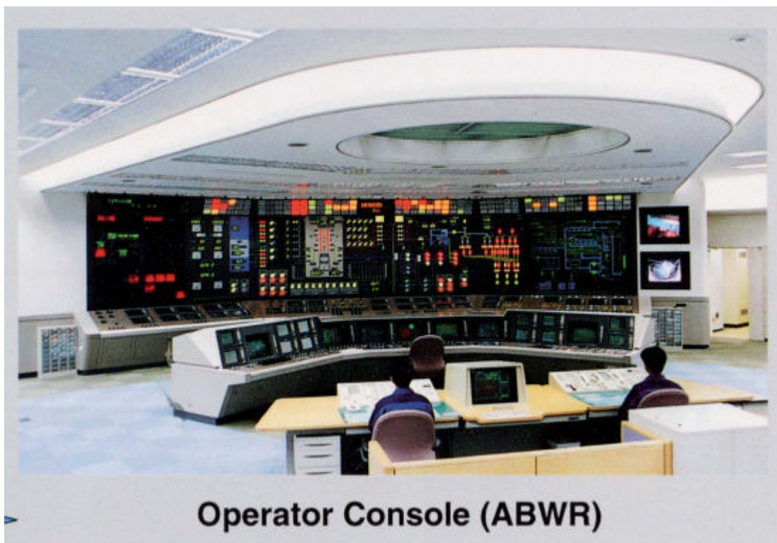
図 1 2 . 1 A B W R の中央制御室
