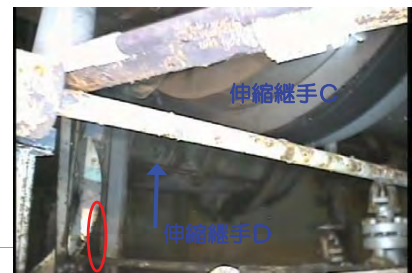
主蒸気配管D
