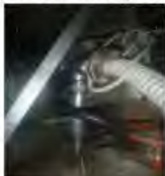
2号機R/B内ダクト(約30mSv/h)
