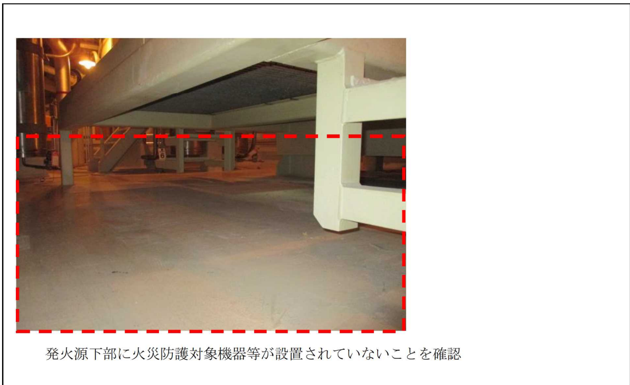
図4 主蒸気内側隔離弁下部
