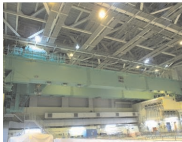
原子炉建屋クレーン
