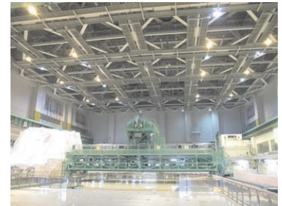
使用済燃料貯蔵プール 上部天井
