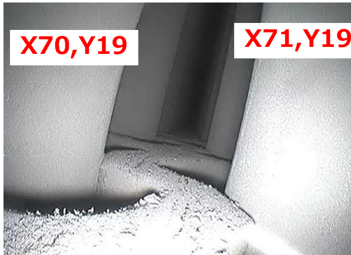
A-SG 第四管支持板上写真
