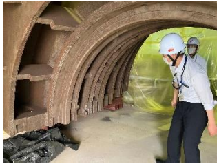
低圧内部車室の内部
