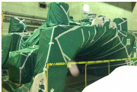
低圧内部車室の保管状況
