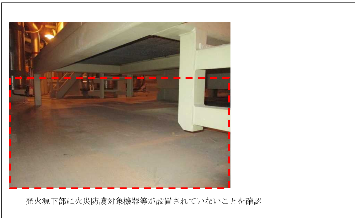
図4 主蒸気内側隔離弁下部
