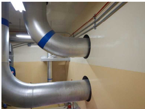
図3 貫通孔の隙間の例
