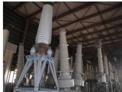
(b) 154kV 開閉所（屋内）
