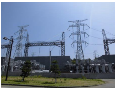
(a) 500kV 超高压開閉所
