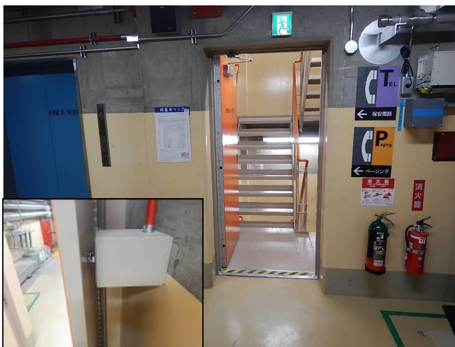
図 9.10-10 対策実施箇所の例示（開放扉の固定）
