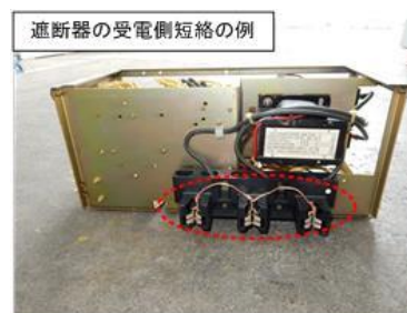
図 4-11 遮断器の短絡箇所 (MCC 試験時)
