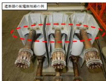
図 4-12 遮断器の短絡箇所 (M/C(D/G)試験時)
