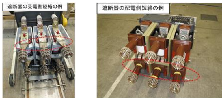
図 4-9 遮断器の短絡箇所 (M/C 試験時)
