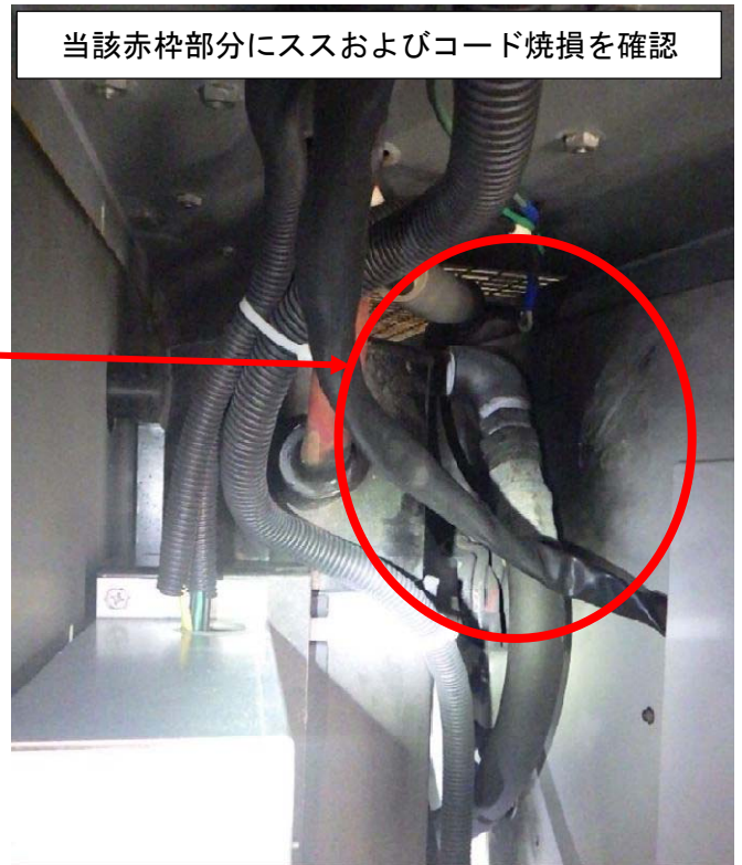
空気圧縮機内部（上部から見たところ）
