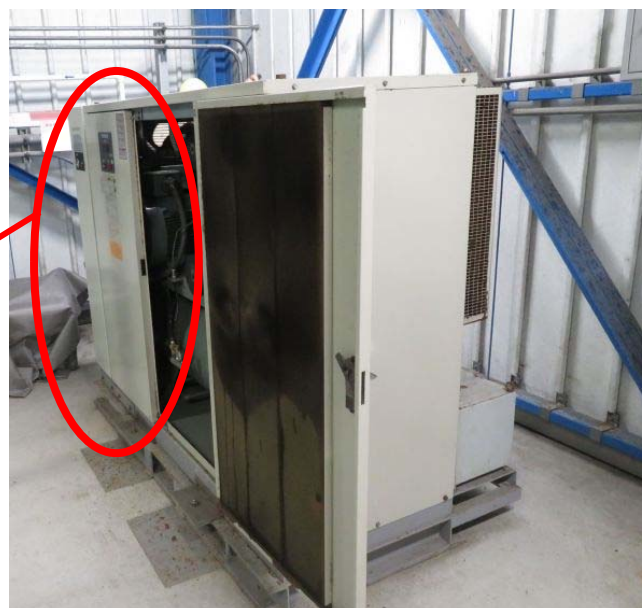
空気圧縮機外観
