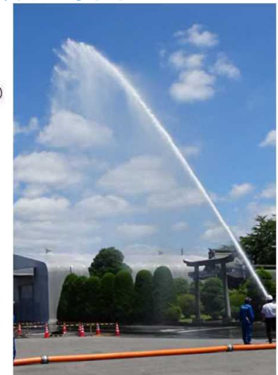
仮設放水設備
