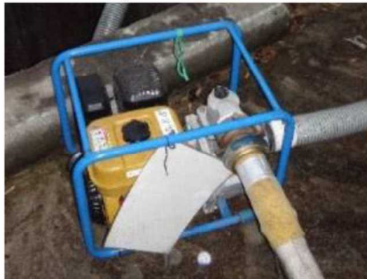
可搬式ポンプ※2
