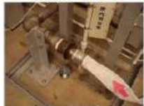
⑥ 可搬型ホースへ使用済燃料ピット補給用冷却配管 接続後
